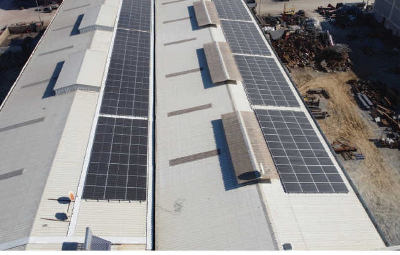
Deha Plastik Ges / ADANA 65 kWp
