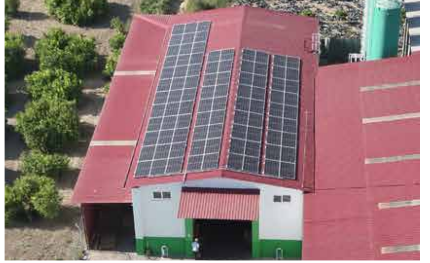
OMKA GÜBRE / ADANA 50 kWp
